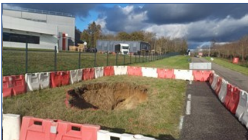
[illustration 1 Vue effondrement 1]
