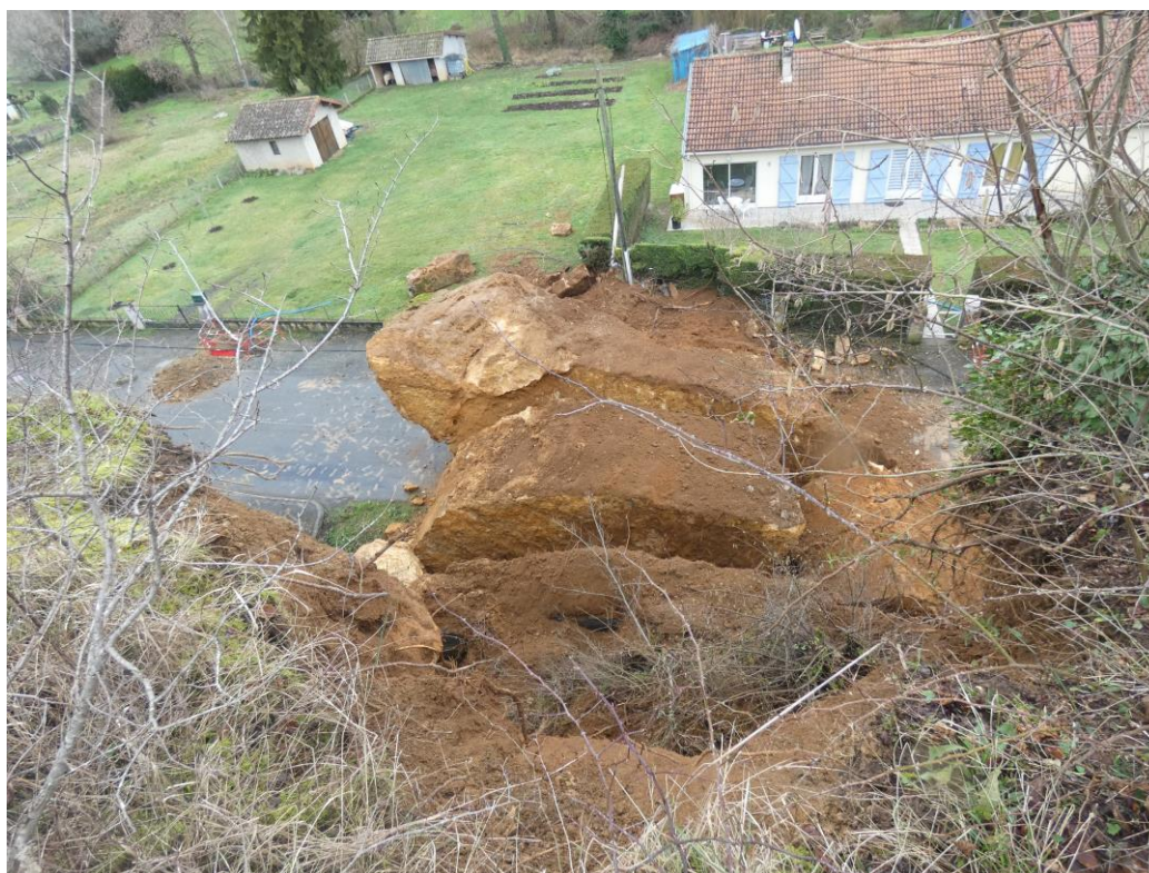
Figure 4 : Eboulement d'Excideuil ; compartiments après fragmentation, vus depuis le sommet de l'escarpement (© C Garnier, BRGM)
