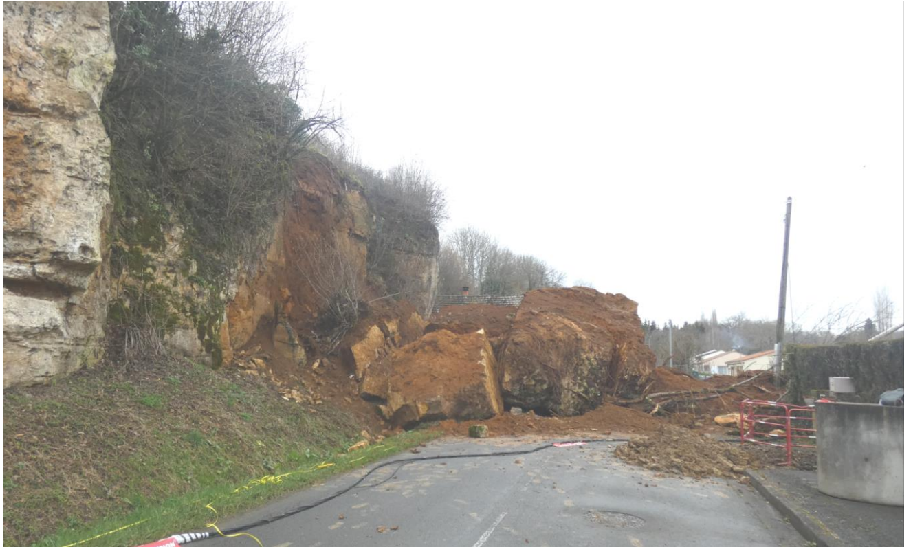
Figure 2 : Eboulement d'Excideuil, vu depuis la chaussée de la RD76 (© C Garnier, BRGM)
