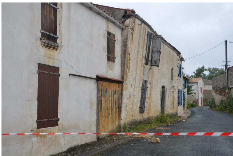
Basculement de façade en maçonnerie, commune de La Laigne (© BRGM - Jean-Christophe Audru)
