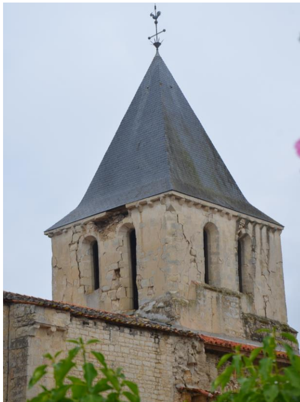
Cisaillement des poteaux du clocher par effet "coup de fouet", commune de La Laigne (© BRGM - Jean-Christophe Audru)
