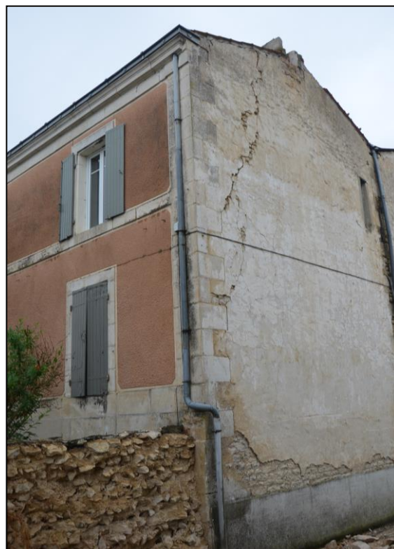
Cisaillement en diagonale sur un pignon en maçonnerie, commune de Cram-Chaban (© BRGM - Jean-Christophe Audru)
