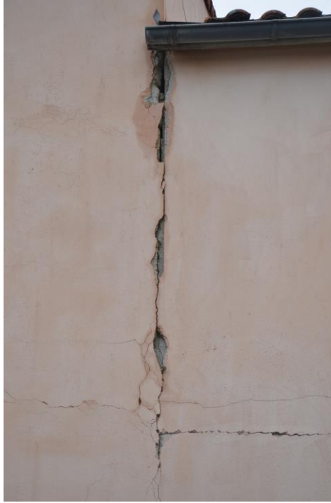
Entrechoquement de deux corps de bâtiments, commune de La Laigne (© BRGM - Jean-Christophe Audru)
