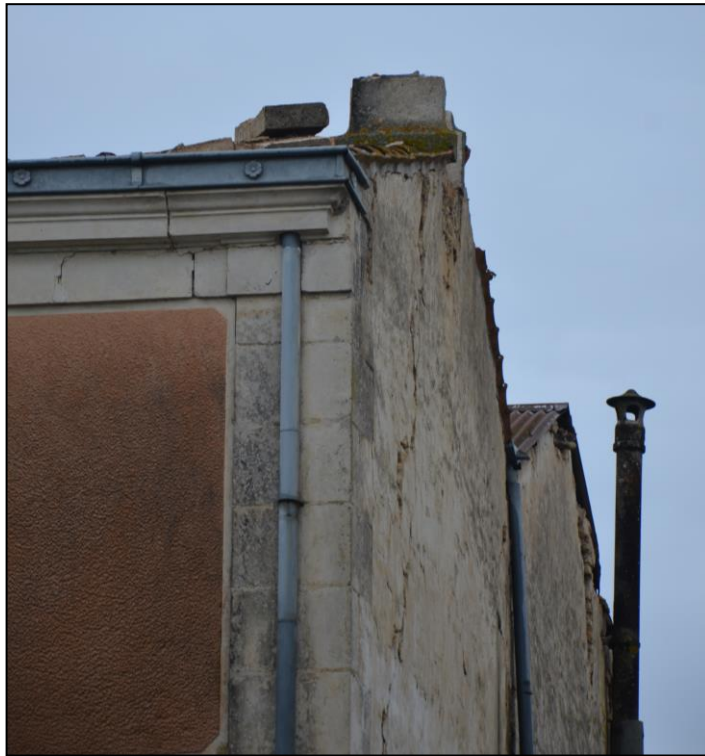
Effondrement de cheminée, commune de Cram-Chaban (© BRGM - Jean-Christophe Audru)
