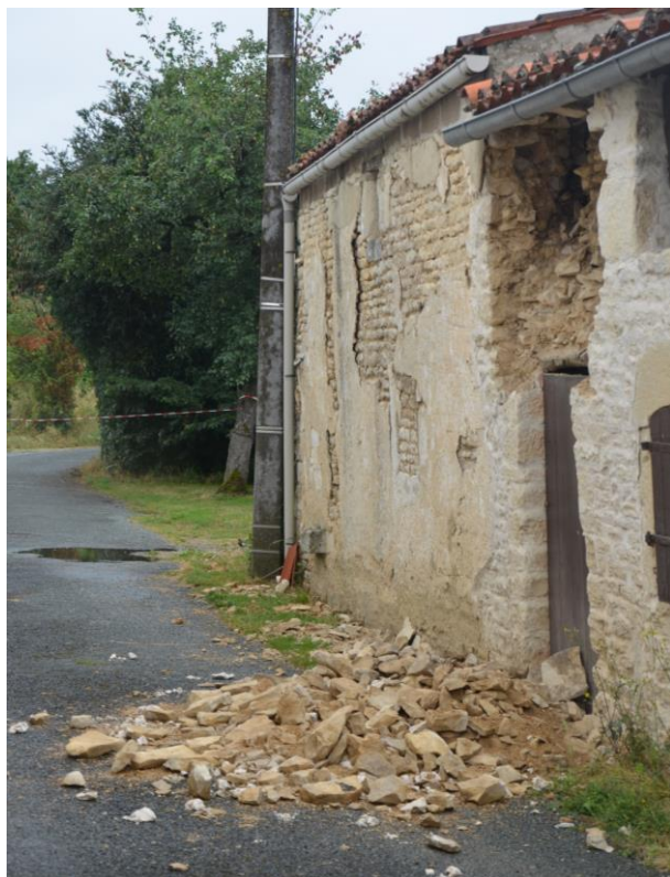
Éjection d'éléments de maçonnerie en façade, commune de La Laigne (© BRGM - Jean-Christophe Audru)
