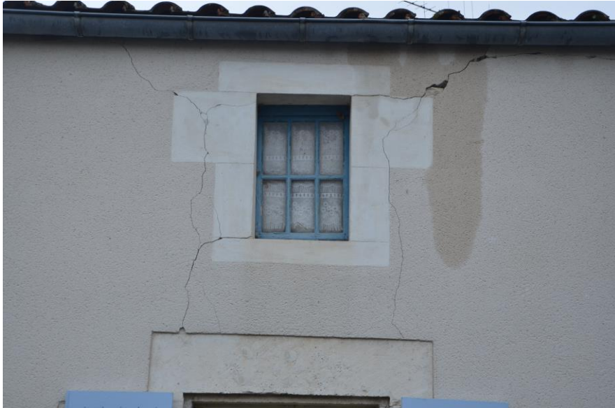
Fissurations entre des linteaux issus de concentrations de contraintes en façade, commune de Cram-Chaban (© BRGM - Jean-Christophe Audru)
