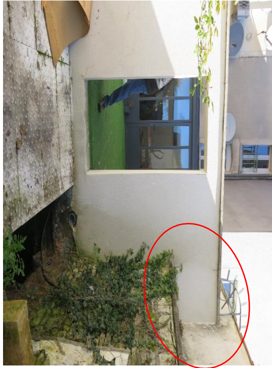
Figure 2 : Localisation du fontis (©BRGM)
